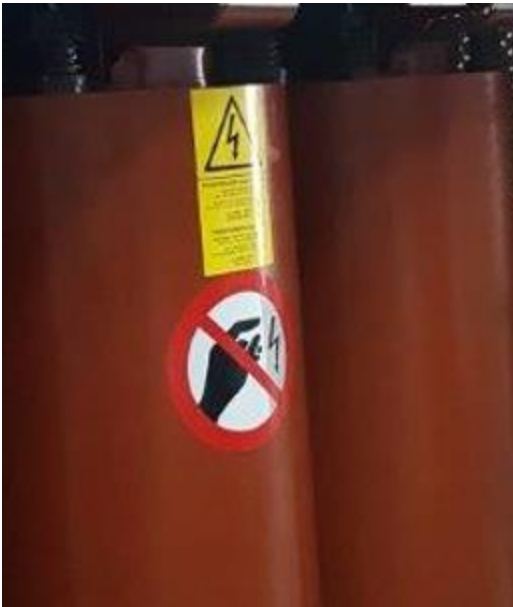
Figura 3 Señalización de prohibición de contacto directo y riesgo eléctrico.
