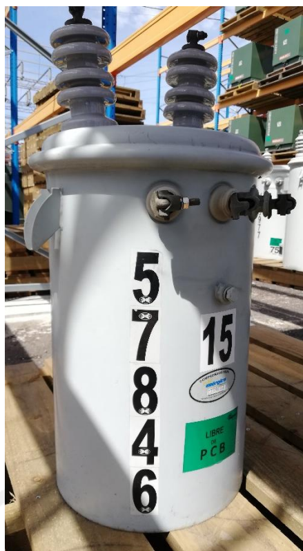
Figura 4 Ubicación sugerida para el adhesivo del número de compañía en transformadores de distribución convencionales tipo poste
