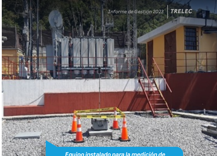
Equipo instalado para la medición de niveles de presión sonora (ruido) en subestaciones
