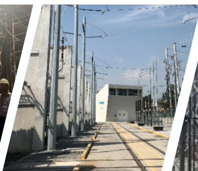
Subestación Incienso 230 KV
